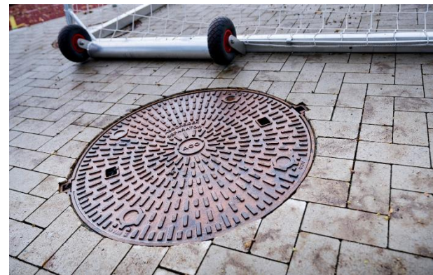
BU: Sichtbar: Die Schachtabdeckung des ACO SPORT® Filtrationsschacht. Darunter befindet sich eine mehrstufige Niederschlagswasser-Behandlungsanlage.
