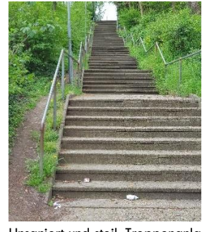
Unsaniert und steil: Treppenanlage Am Großen Geeren
