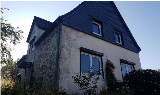
Höherer Sanierungsbedarf einer Fassade am Mühlenberg
