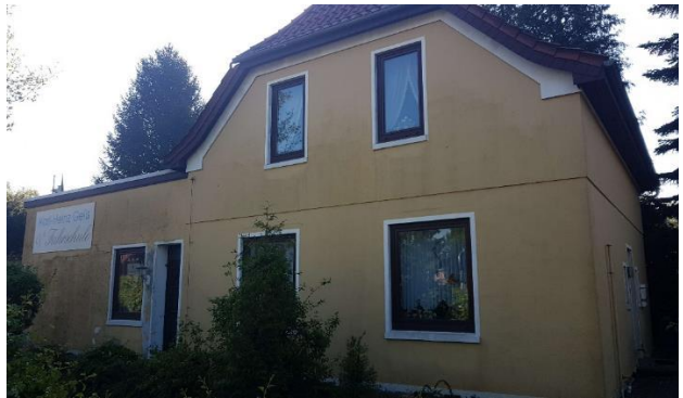
Höherer Sanierungsbedarf von Fassade und Fenstern
